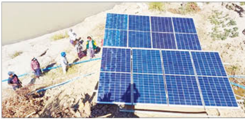
ကျေးရွာတစ်ရွာ၌ စီမံကိန်းအရ ဆောင်ရွက်ထားသည့် ဆိုလာဗီလင်းရေလုပ်ငန်း။
