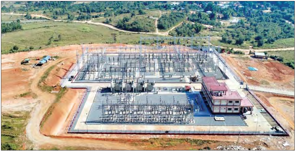
ကျိုင်းတုံဓာတ်အားခွဲရုံကို တွေ့ရစဉ်။
