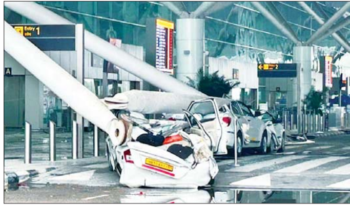
အင်ဒိုရာနီအပြည်ပြည်ဆိုင်ရာလေဆိပ်၌ မျက်နှာကြက် ပြိုကျမှုကြောင့် ရပ်နားထားသည့် ကားများ ပျက်စီးနေမှုကို တွေ့ရစေ့။
