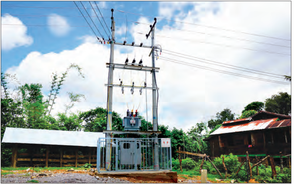
ဒီးမော့ဆိုမြို့နယ်၌ မီးလင်းရေးတပ်ဆင်တည်ဆောက်ထားသော ထရန်စဖော်မာ တစ်ခုကို တွေ့ရစဉ်။
