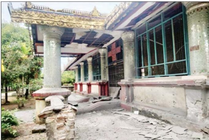
ကျောင်းဆောင် ထိခိုက်ပျက်စီးမှုအား တွေ့မြင်ရစဉ်။
