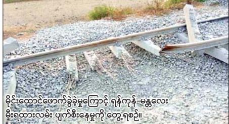
မိုင်းထောင်ဖောက်ခွဲမှုကြောင့် ရန်ကုန်-မန္တလေး မီးရထားလမ်း ပျက်စီးနေမှုကို တွေ့ရစဉ်။
