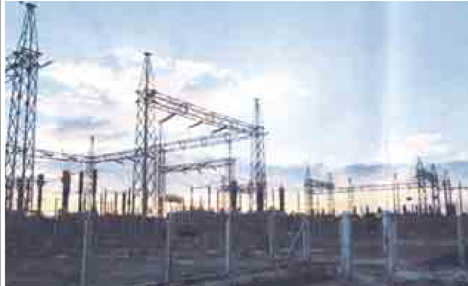
၁၃၂/၆၆/၁၁ ကေဗီ ဝိုင်းမော်ဓာတ်အားခွဲရုံ Switch Yard ။
