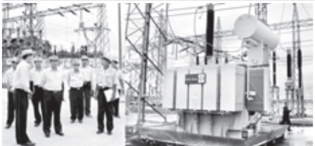
အမှတ်(၂)လျှပ်စစ်စွမ်းအားဝန်ကြီးဌာန၊ ပြည်ထောင်စုဝန်ကြီး ဦးခင်မောင်စိုး ကျောက်တံခါးမြို့နယ် (၂၃၀)ကေဂရီ သာယာကုန်း ပင်မဓာတ်အားခွဲရုံ Switch Yard အတွင်း ကြည့်ရှုစစ်ဆေးစဉ်။ (သတင်းစဉ်)
