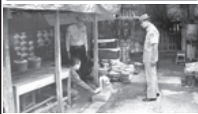
မြောင်းမြမြို့နယ် မြို့မဈေးကြီးအတွင်း စီးသေးကြိုတင်ကာကွယ်ရေးအတွက် စီးသတ်ရေငတ်များ တပ်ဆင်ဆောင်ရွက်ထားရှိမှုကို ၈ နံနက် ၅ ရက်က အမှုဆောင်အရာရှိ ဦးမောင်တိုးနှင့် အင်ဂျင်နီယာများ ဦးနိုင်လင်းမောင်တို့ တွင်းဆင်းစစ်ဆေးကြစဉ်။ (မြို့နယ်စည်ပင်)
