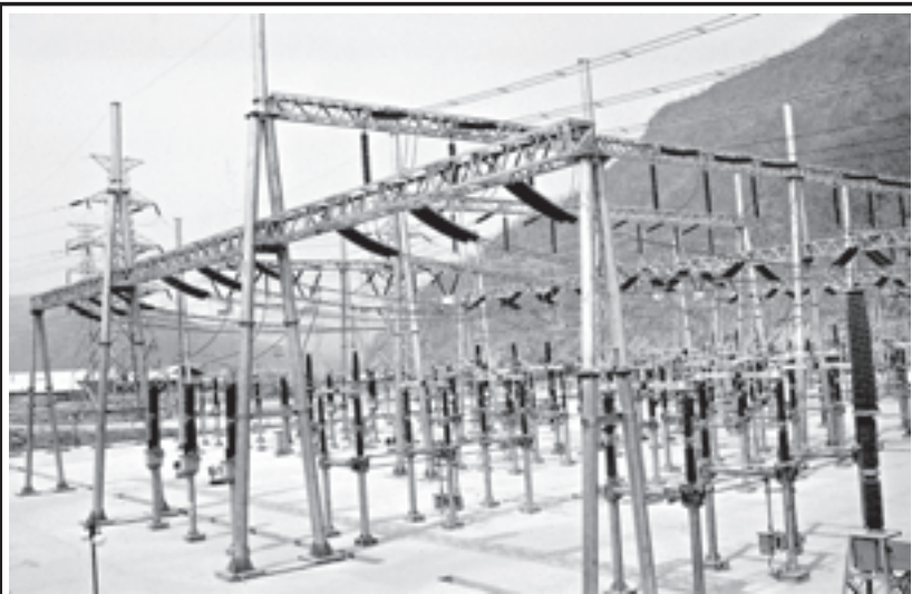
ရဲရွာရေအားလျှပ်စစ်ဓာတ်အားပေးစက်ရုံအနီးရှိ Switchyard ကို ဤသို့ တွေ့ရသည်။
