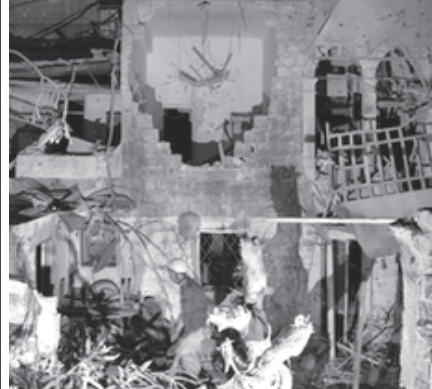
ဟန်ခ်ဘိုလာတို့ ပစ်ခတ်လိုက်သောဒုံးကျည်များကြောင့် ဟိုင်ဟန်မြို့ မြောက်ပိုင်းတွင် ပျက်စီးနေသည့်အဆောက်အအုံတစ်ခုကို ဩဂုတ် ၆ ရက်က တွေ့ရစဉ်။
