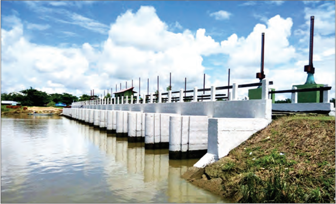
စီမံကိန်းမှ တည်ဆောက်ခဲ့သည့် ကျိုက်လတ်မြို့နယ်အတွင်းရှိ ထန်းပင်ပျိုရေတံခါး (၈' x ၈' - ၂၁ ပေါက်)အား တွေ့မြင်ရစဉ်
