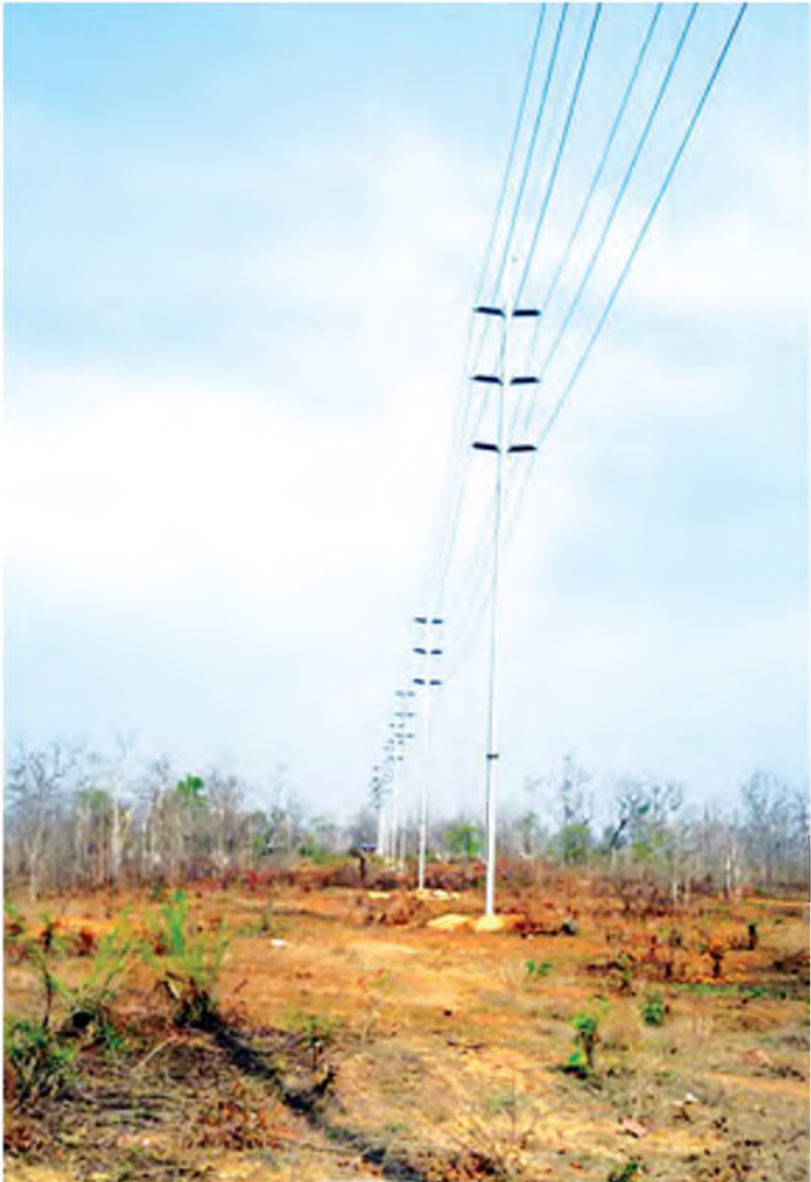
ဘော်လစ်မြို့တွင်း၌ လျှပ်စစ်ဖြန့်ဖြူးရေးအတွက် Cantilever Type 66 KV ဖြင့် ဓာတ်အား လိုင်းသွယ်တန်းထားရှိမှုကိုတွေ့ရစဉ်။
