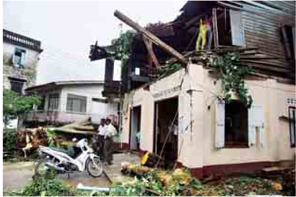
မုန်တိုင်းဒဏ်ကြောင့် ပြိုကျပျက်စီးသွားသည့် အဆောက်အအုံတစ်ခုကို တွေ့ရစဉ်။
