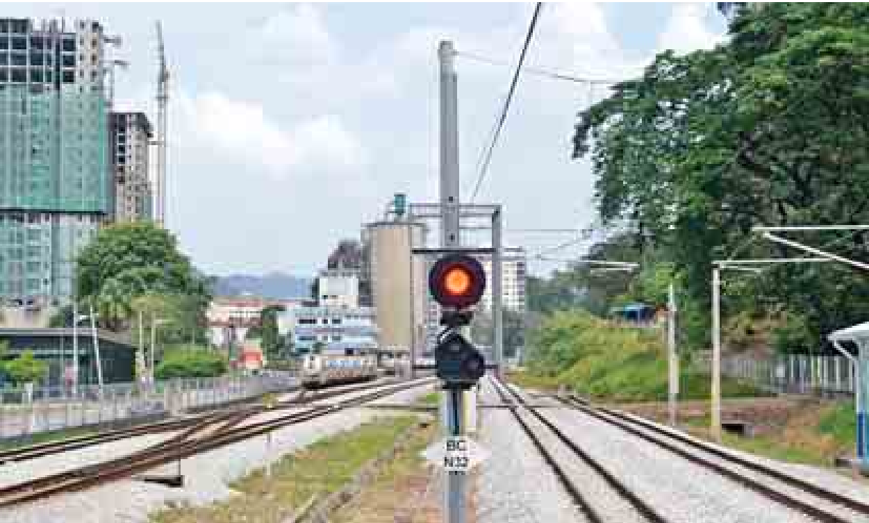
နိုင်ငံတကာ မီးရထားလမ်းတစ်လျှောက် Optical Fiber Cable ဆက်ကြောင်းများ ဆောင်ရွက်ထားရှိမှုကို တွေ့ရစဉ်။
