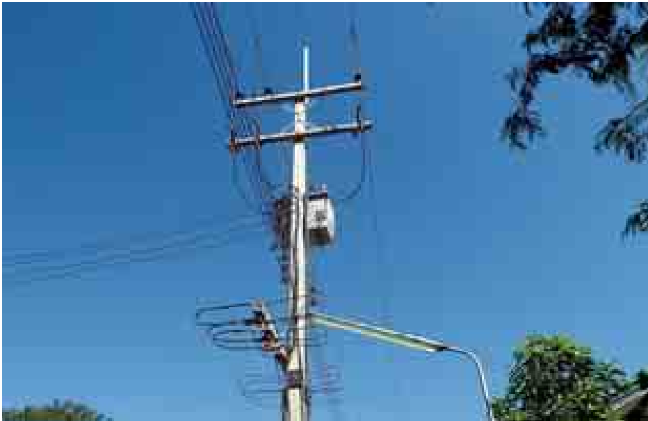
Transformer မှတစ်ဆင့် Insulated Cable နှင့် Connector များအသုံးပြု၍ ဓာတ်အားဖြန့်ဖြူးထားပုံ။
