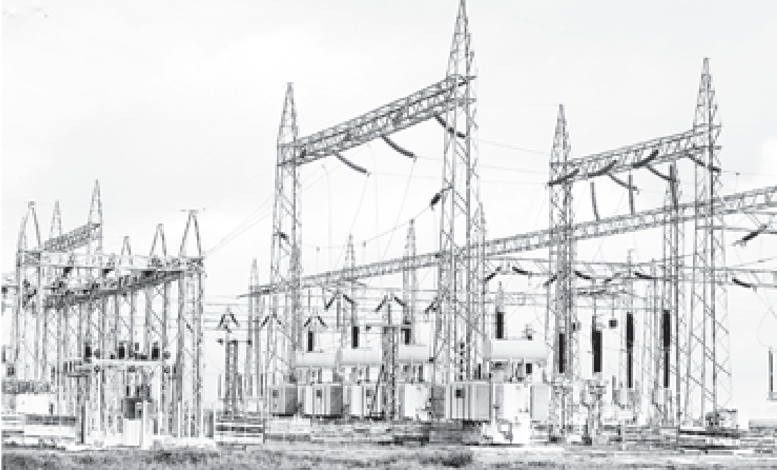
သာယာကုန်း ၂၃၀ ကေဇွီ ပင်မဓာတ်အားခွဲရုံရှိ Switch Yards ကို တွေ့ရစဉ်။
