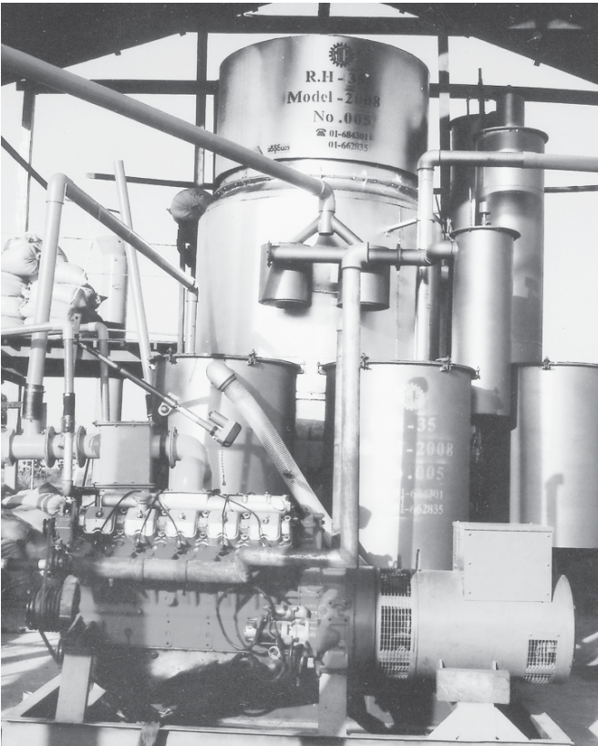
ရန်ကုန်တိုင်းတွဲတေးမြို့နယ် သဝန်းတောကျေးရွာတွင် ရန်ကုန်မြို့တော်လျှပ်စစ်ဓာတ်အားပေးရေးအဖွဲ့နှင့် ကျေးရွာလူထုတို့ ပူးပေါင်းတည်ဆောက်ခဲ့သည့် စပါးခွံလောင်စာသုံးဓာတ်အားပေးစက်ကို တွေ့ရစဉ်။
