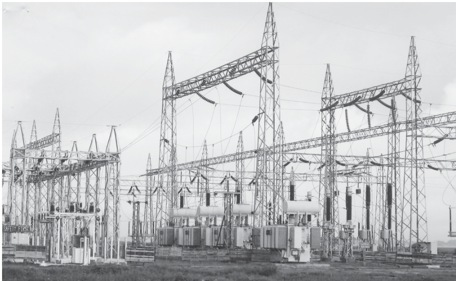
သာယာကုန်း ၂၃၀ ကေဗီ ပင်မဓာတ်အားခွဲရုံရှိ Switch yards ကို တွေ့ရစဉ်။
