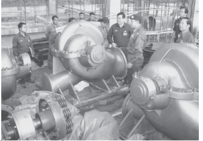
ရန်ကုန်မြို့တော် စည်ပင်သာယာ ရေးကော်မတီဥက္ကဋ္ဌ၊ မြို့တော်ဝန် ဗိုလ်မှူးချုပ် အောင်သိန်းလင်း ရေကူး စက်ရုံရှိ ရေဂါလန် တစ်သန်းဆုံ ရေကောင်းကန်မှ သောက်သုံးရေများ ရန်ကုန်မြို့နယ် အသီးသီးသို့ ထပ်မံ ပြည့်ဆည်းရာတွင် အသုံးပြုမည့် ရေကုန်းစက်များကို စစ်ဆေးစဉ်။ (၁၉)
