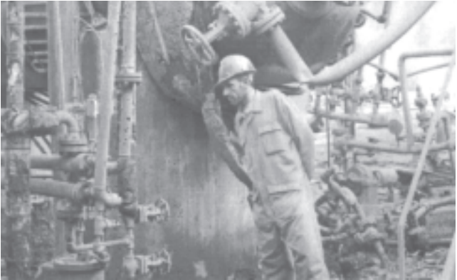
အီရတ်နိုင်ငံတွင် ခုခံရေးသမားများက ဘက်ဆိုင်ရုံမှတိုက်ခိုက်လျက်ရှိရာ ဘဂ္ဂဒက်တောင်ပိုင်းရှိ ဒီရိုရာရေနံချက်စက်ရုံ ပျက်စီးနေသည်ကို ဇန်နဝါရီ ၄ ရက်က တွေ့ရစဉ်။ (ဓာတ်ပုံ-အင်တာနက်)
