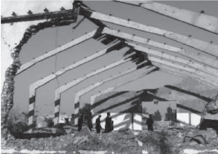
အီရတ်စစ်ပွဲ၏ အကျိုးဆက်တစ်ရပ်အဖြစ် အများပြည်သူဆိုင်ရာ အဆောက်အအုံများ၊ ဆေးရုံများ၊ ဆေးပေးခန်းများနှင့် အိုးအိမ်များ ထိခိုက်ပျက်စီးခဲ့ရသည်။ စစ်ကာလအတွင်း ဗုံးကြဲခံခဲ့ရသော မြို့တော်ဘုရားရှိ အဆောက်အအုံတစ်လုံး ပျက်စီးနေသည့်ကို မတ် ၂၆ရက်က တွေ့ရစဉ်။ (ဓာတ်ပုံ-အင်တာနက်)
